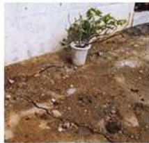
地割れが改良地盤で止まっている
