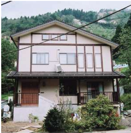
灯油タンクやエアコンの室外機が倒れているが建物には問題なし
